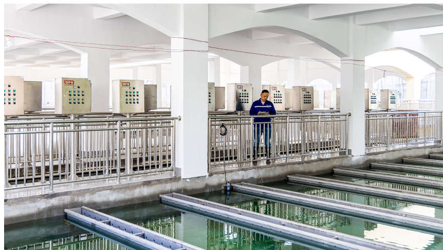
工作人员对鹰岩水厂扩能项目二期一机组运行设备运行及水质情况进行检查登记。 特约通讯员 罗建 摄
