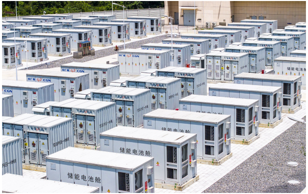
中广核储电站。 记者 甘昊旻 摄
