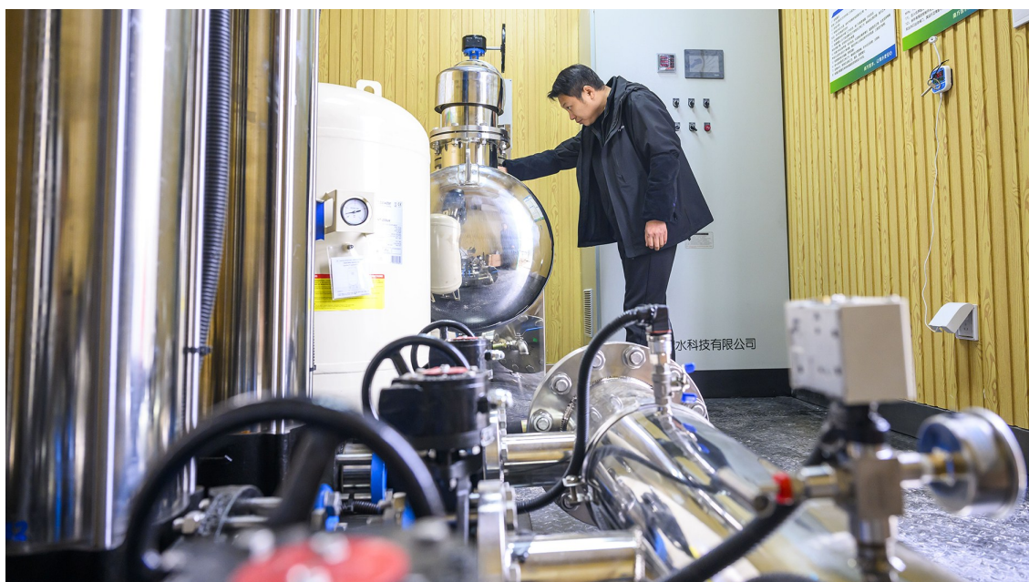
12月8日,工作人员查看水江镇长青社区自来水加压设施运行情况。
