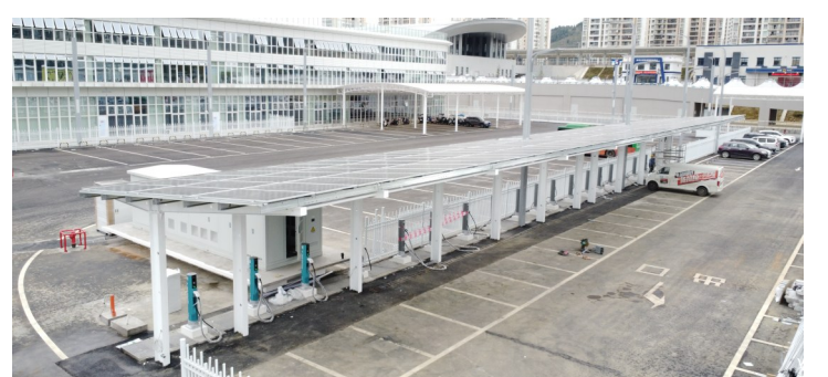
南川高铁北站光储充一体化超充站。
